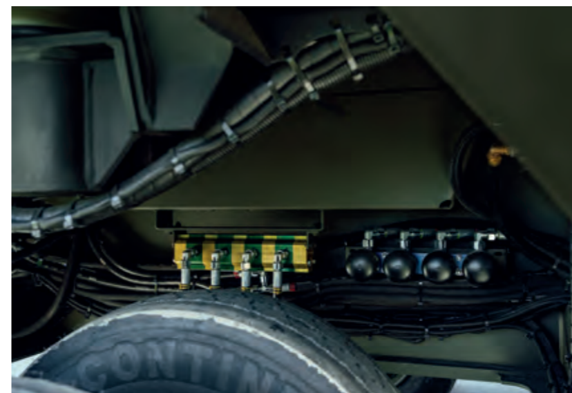
Instalacje z ergonomicznym dostępem rewizyjnym.
